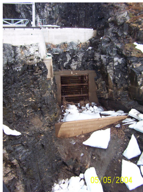
Figur 3. Øvre inntak (Foto A. Tvede).
